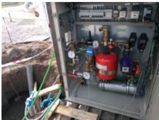
Figura 2: Sistema de test de respuesta térmica (TRT).
