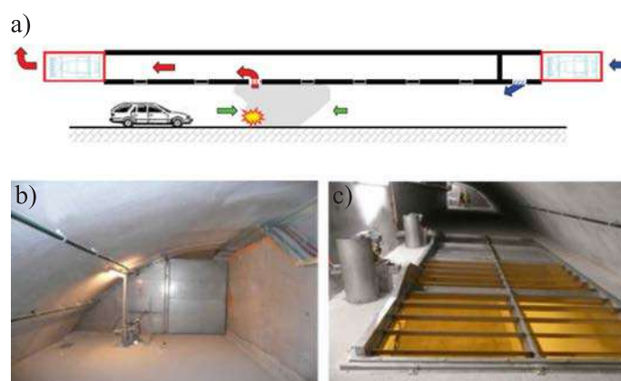
Figura 23: Túnel de Katschberg, Austria: a) instalación de toberas Saccardo en túneles existentes para controlar la corriente de aire en el túnel, b) muro de separación y c) inyección de aire fresco (Sturm et al. , 2014, 2017).
