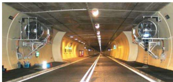
Figura 22: Túnel de Bosruck, Austria. Instalación de 8 grandes jet-fans de 2700 N cada uno en 4 nichos de ventilación en lugar de los 40 jet-fans que hubieran sido necesarios para cada tubo (Sturm et al. , 2017)
